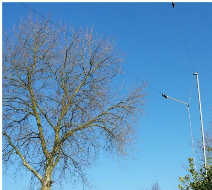
En een plaatje van de ophanging. Hier zie je 1 hoek met bovenaan net zichtbaar de 5400kHz trap en er onder de 3600kHz trap.
